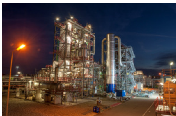
Bild 1: Der neue Destillationsturm wird zur Produktion von Regalite genutzt.
